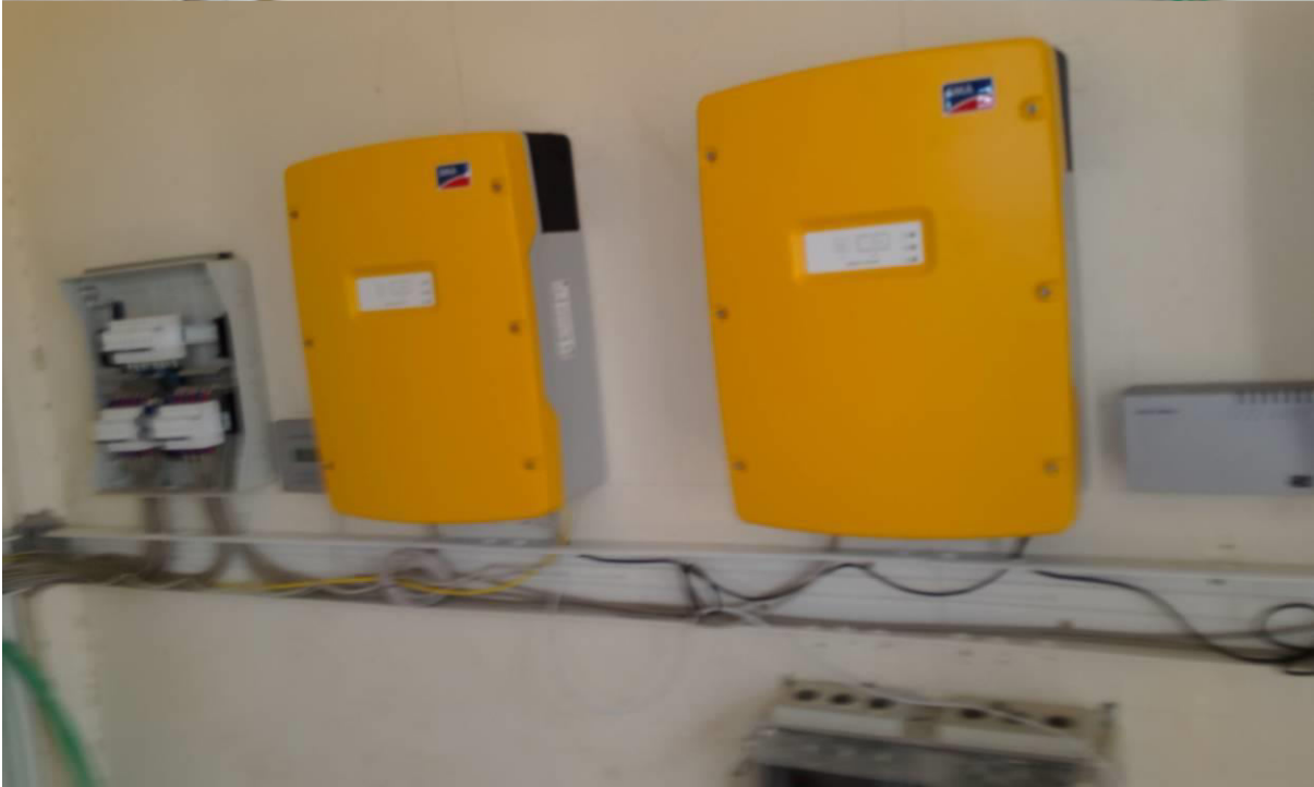
Photos 11-12: Onduleur réseau et onduleur/chargeur installés sur site
