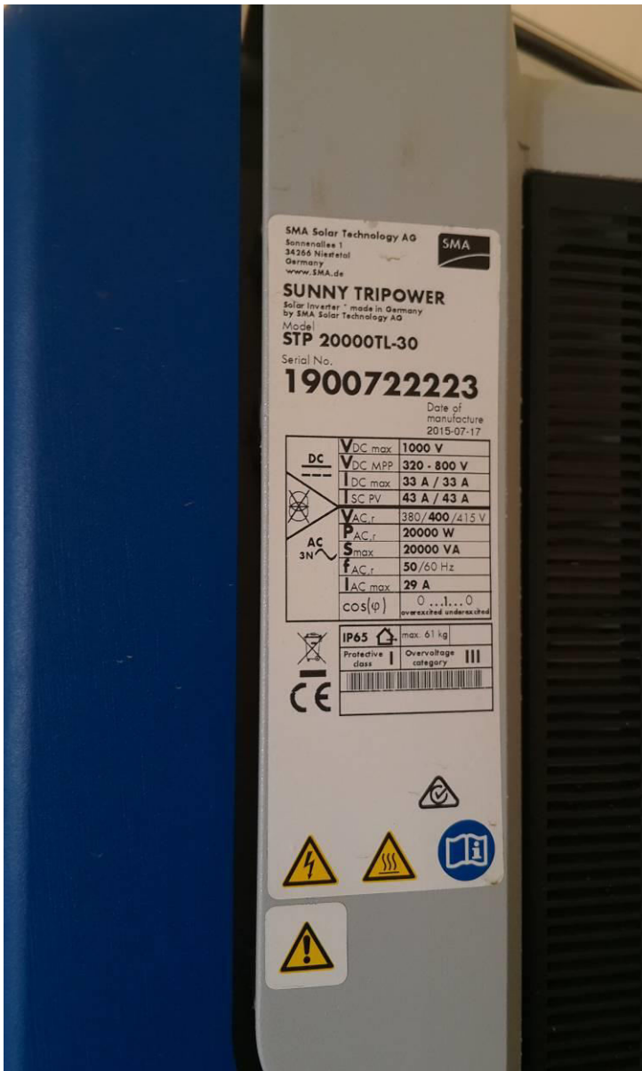
Photo 10 : Onduleur réseau Tripower SMA
