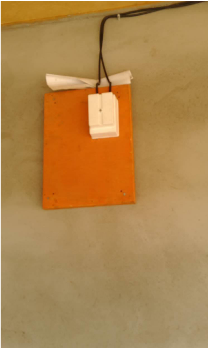
Photo 9: Tableau de raccordement électrique
